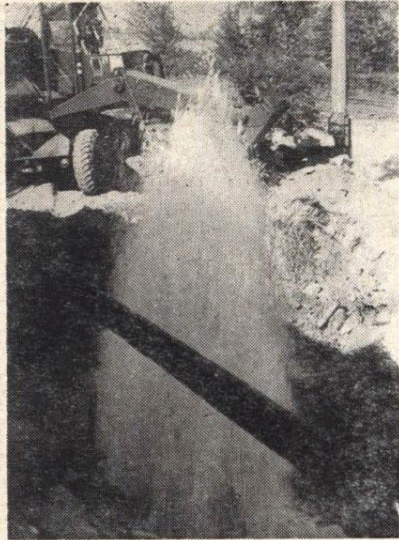
Woda wyżej! Operator — zacement tyżką koparki o rurę wodociagową... Budowlani przystępując do robót winni sprawdzić, co się kryje pod ziemią. Fot.: G. Sykała
